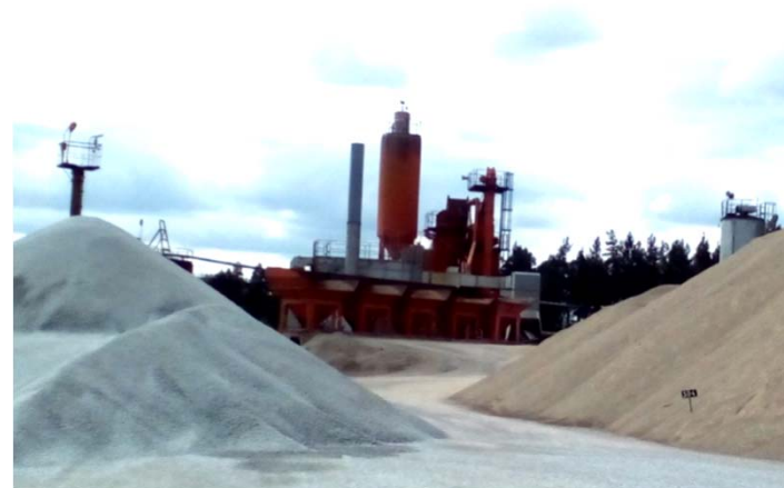
1.att. Asfaltbetona rūpnīca (autora foto)
